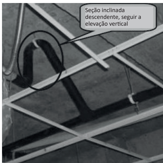
Figura 3-5.7: Seção inclinada para baixo da tubulação de drenagem
